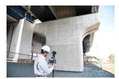
AIひび割れ解析ソリューション
